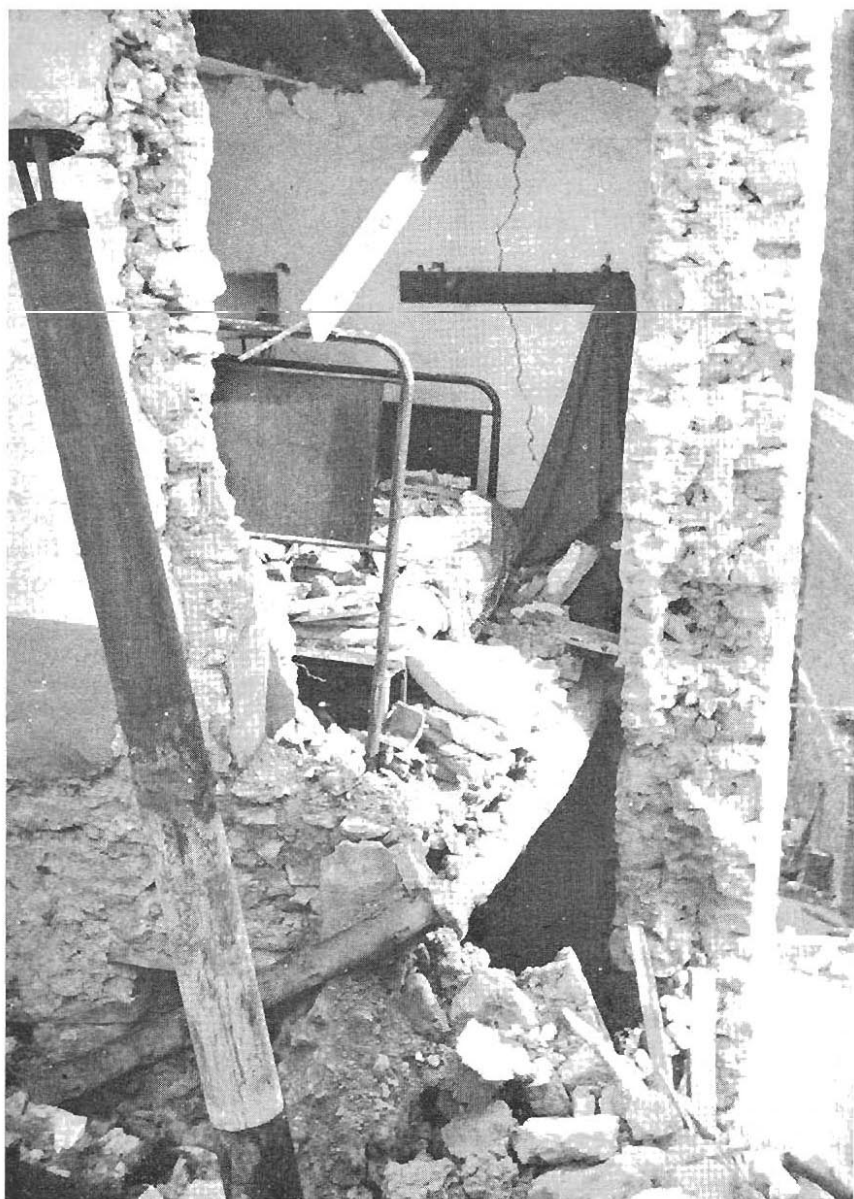
FIG. 4 — TERREMOTO DI NORCIA (1979). Particolare di una casa danneggiata.
